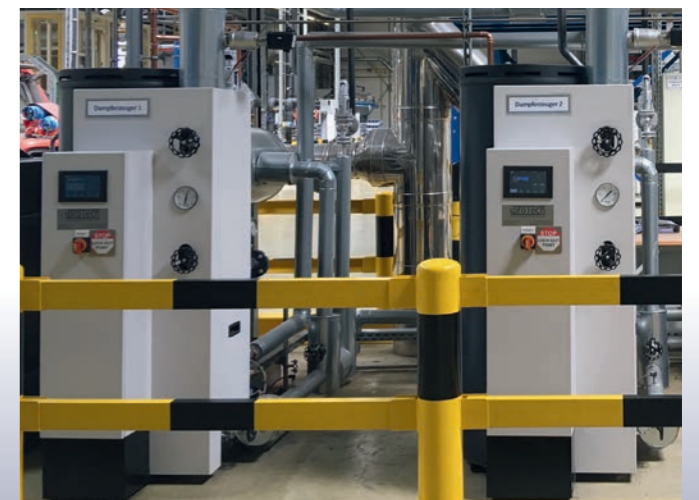
Für ausreichend saturierten Dampf sorgen elektronische Dampferzeuger, hier als Tandemanlage installiert, die sich mit einer Leistung von je 800 kg/h durchaus sehen lassen können.
